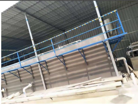
项目污水处理站
